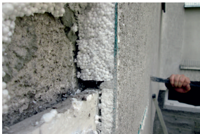
FOT. 3. TZW. PODKLEJKI ORAZ BRAK STYKU PŁYT - MOSTEK TERMICZNYCH LINIOWY (FOT. ARCHIWUM AUTORA)
