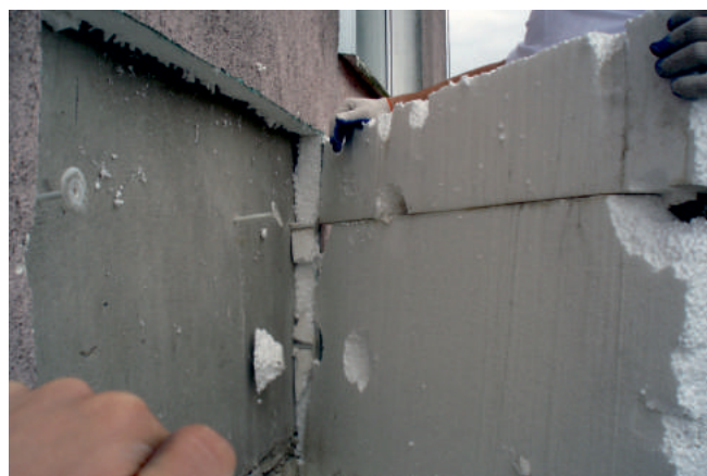
FOT. 2. ISTNIEJĄCE OCIEPLENIE NIEPRZYKLEJONE DO PODŁOŻA (FOT. ARCHIWUM AUTORA)
