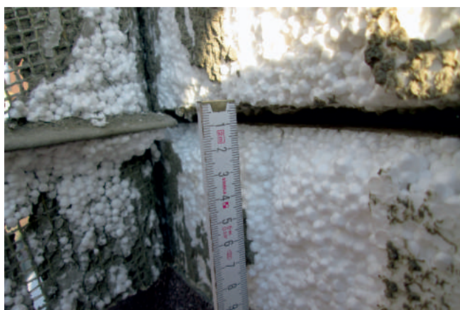
FOT. 8. BRAK PRAWIDŁOWEGO POŁĄCZENIA PŁYT STYROPIANU, KLEJ W SPOINIE (FOT. ARCHIWUM AUTORA)
