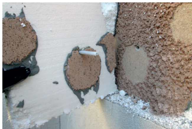
FOT. 4. ODSPOJENIE OCIEPLENIA Z CZĄSTKAMI PODŁOŻA I BRAK SKUTECZNOŚCI MOCOWANIA MECHANICZNEGO (KOŁKA) (FOT. ARCHIWUM AUTORA)
