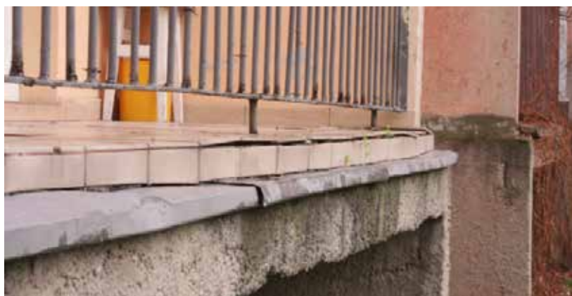
Korozja obróbki blacharskiej oraz uszkodzenia części okładziny na czole balkonu
