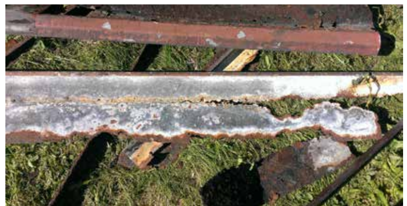
Stan obróbki blacharskiej po kilku latach użytkowania na balkonie
