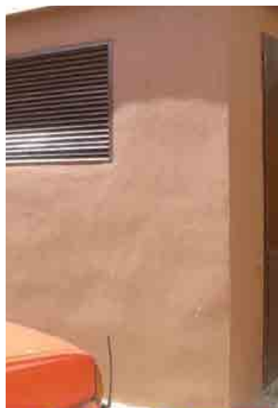
Widoczne nierówności ścian
