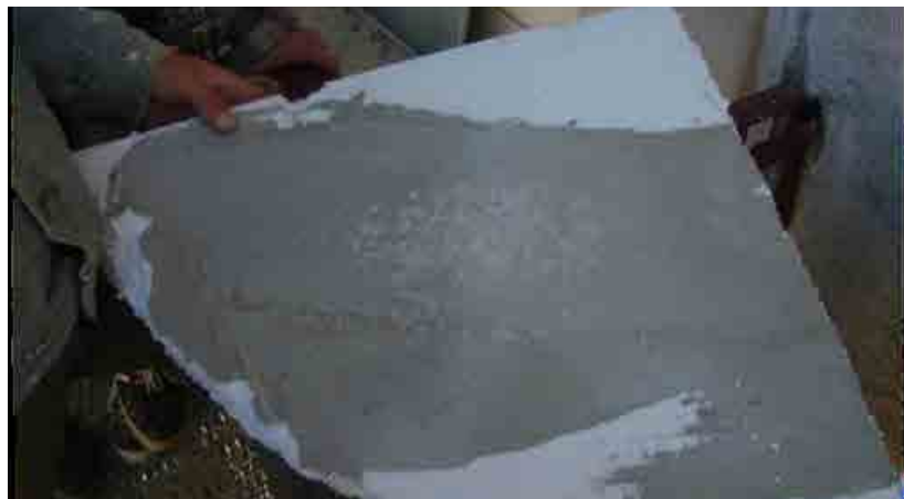
Skutki nieprawidłowego mocowania termoizolacji
