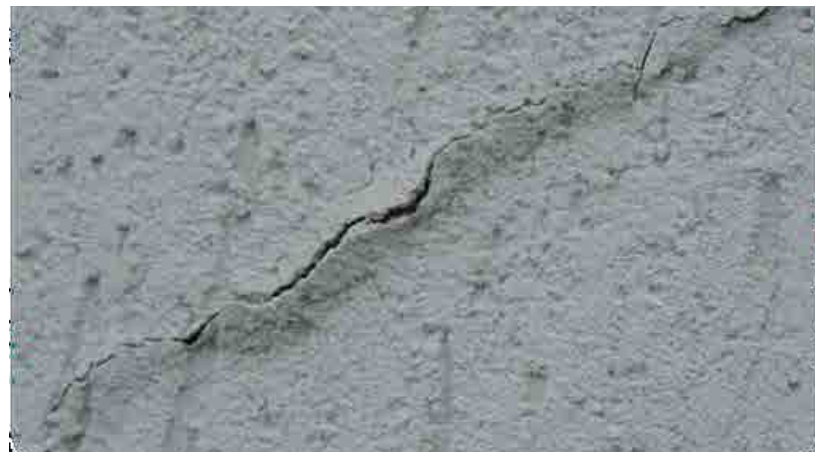
Pęknięcie warstwy zewnętrznej ocieplenia.
