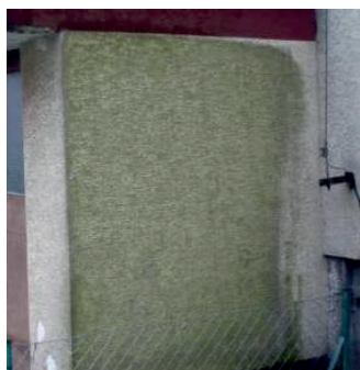
Ściana porażona glonami (alga)
