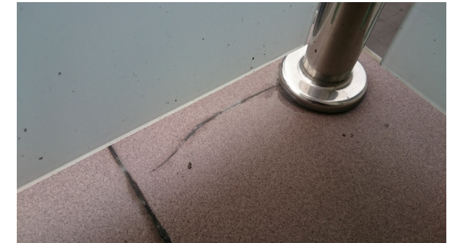
Fot. Korozja barierek i uszkodzenia okładziny ceramicznej.
