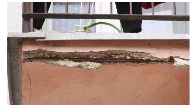
Fot. Ubytki i zarysowania betonu oraz korozja stali zbrojeniowej na płycie balkonowej
