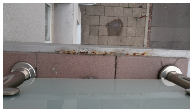
Fot. Korozja powlekanych obróbek blacharskich.
