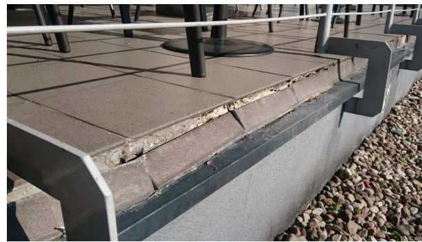
Fot. Zacieki, korozja obróbki blacharskiej oraz uszkodzenia części okładziny na czołe balkonu/tarasu.
